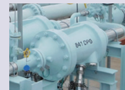
タービン発電機
